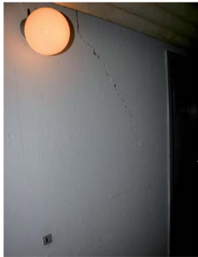
Sætningskade i skillevæg i kælder
