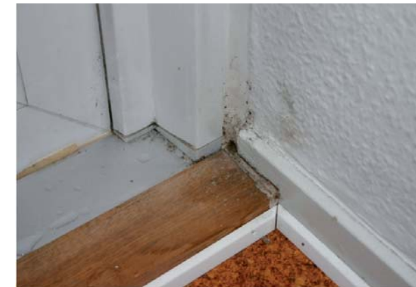
Bundstykke med kondensvand
