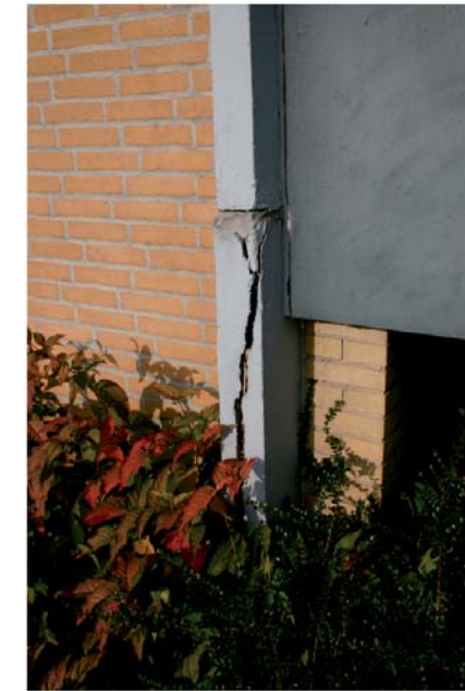
Meget medtaget betonsøjle i facaden
