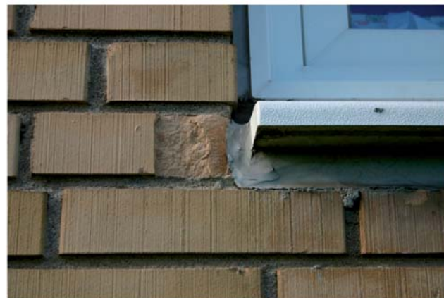
Afskallet teglsten ved ende af sålbænk
