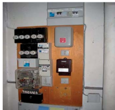
Hovedfordelingstavle i anden teknikrum i kælder
