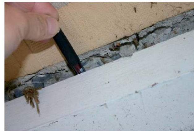
Manglende fuger ved dørkarm
