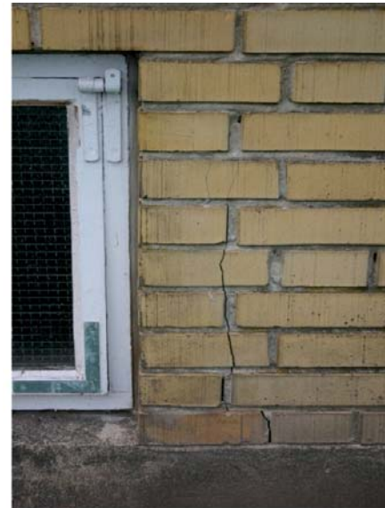
Sætningskade i murværk
